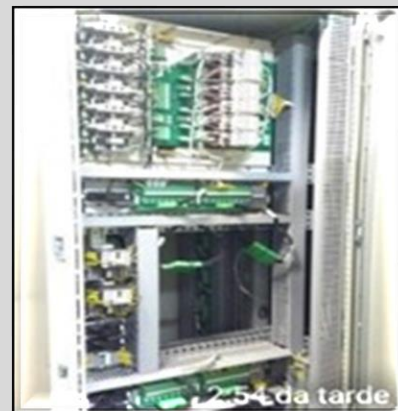
Gabinete de terminação de cabos
